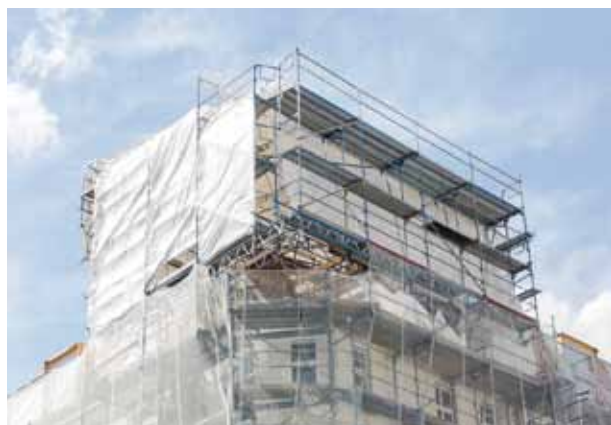
Wo nicht das Ziel, wird die Verdrängung von Mietern durch Modernisierung doch fast überall in Kauf genommen – wie im Fall von Mieter Peter Berendt in der Düsselendorfer Straße (Fotos oben), in der Winsstraße (unten links) oder in der Koppenstraße (unten rechts)
