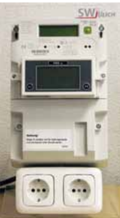
Foto: Stadtwerke Jülich
